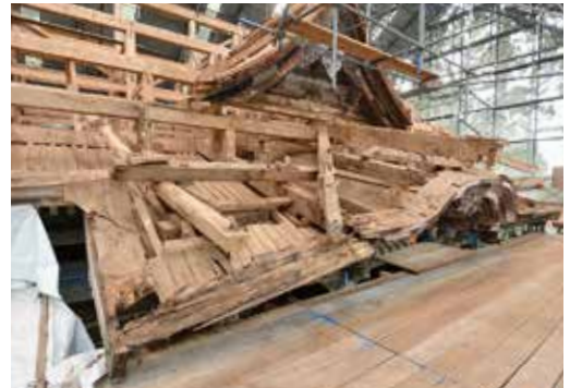
2-1. 屋根の解体後、向拝の破損状況
