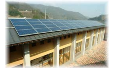
大屋小学校の太陽光発電設備
